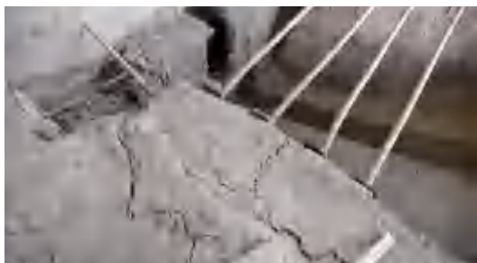
洞阳东吴墓墓道口左侧夯土台面裂隙病害
